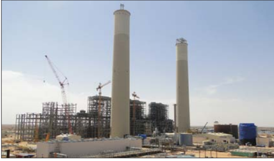
36 Libya - Al-Khalij 4x350 MW Enerji Santrali Projesi
