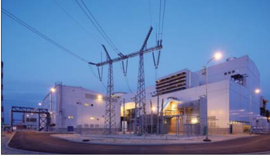
34 Letonya - Riga 420 MW Elektrik ve 270 MW Termal Çevrim Santrali
